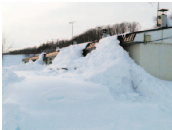
暴風雪後の町営住宅(平成27年3月)
